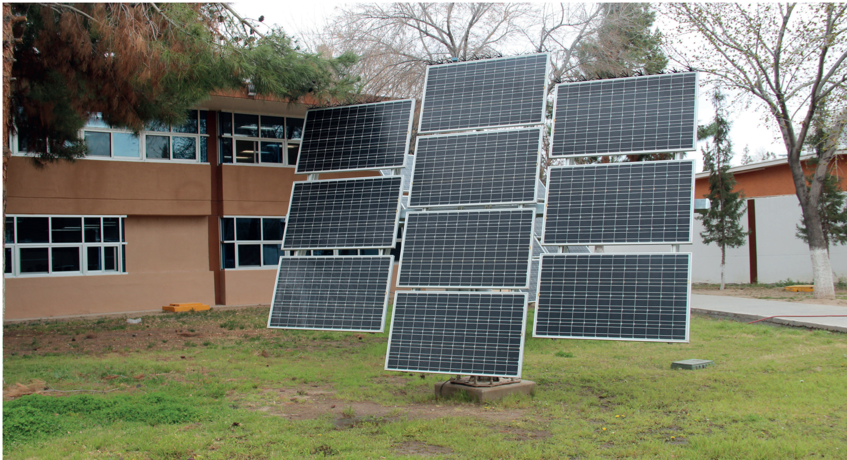
Paneles fotovoltaicos en el Instituto de Ingeniería y Tecnología.
